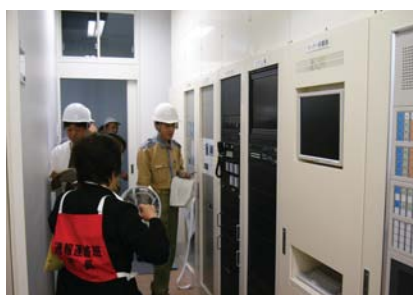
自衛消防隊通報連絡班による非常放送訓練。1階監視室にて
