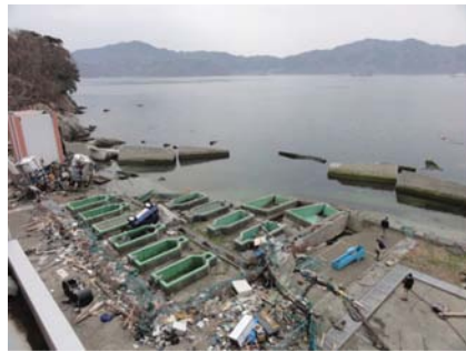
写真6 研究棟屋上から見た屋外コンクリート水槽(写真中央に複数ある緑色の容器)。防波堤が破壊され海側に倒れていることから引き波により破壊されたことが判る。センター敷地の一部が崩れて海水が浸食し、水槽の一部も水没している。
